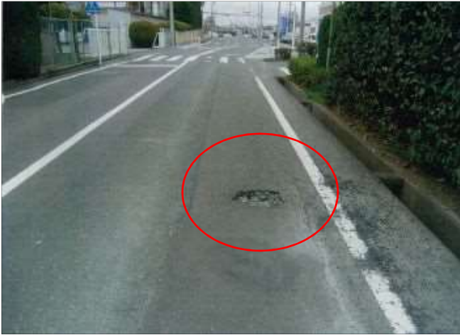
① 舗装に穴があいている。
