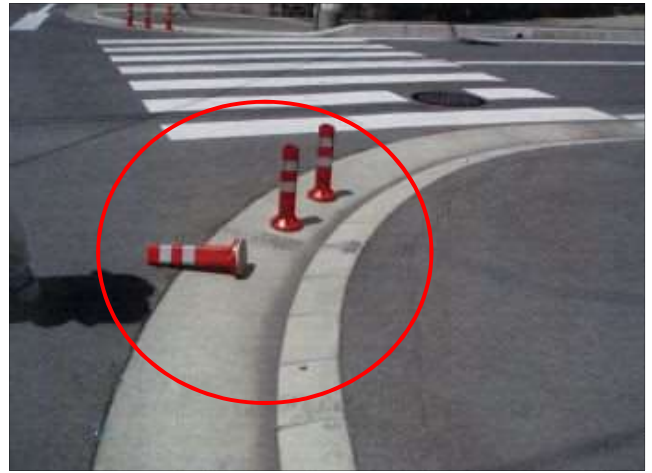
② 安全施設等が破損している。
