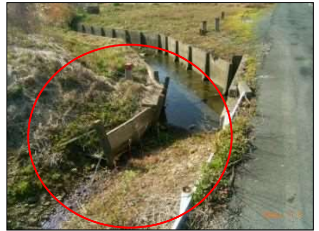
④ 排水路が破損している。
