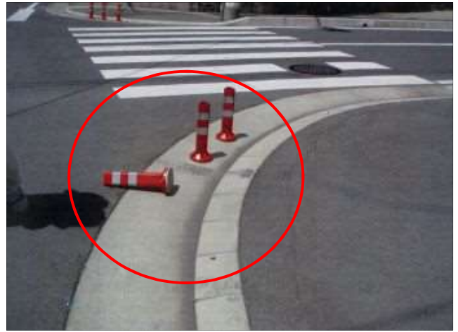
② 安全施設等が破損している。
