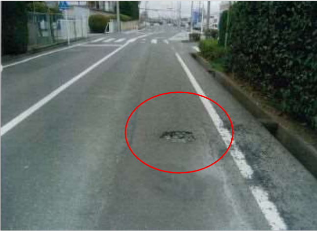
① 舗装に穴があいている。
