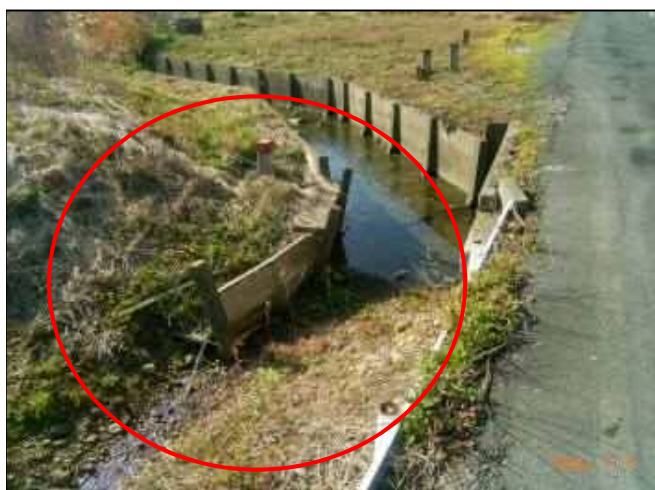
⑤ 排水路が破損している。
