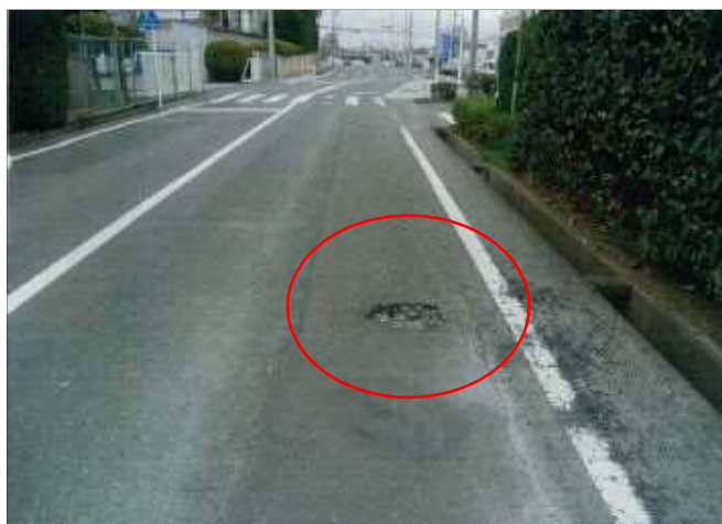
① 舗装に穴があいている。
