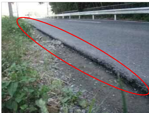
② 路肩が欠落し危険である。
