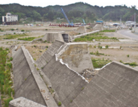
▲津波によって破壊された田老町のスーパー堤防
