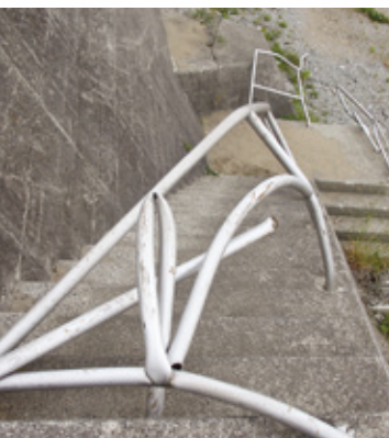
▲グニャグニャに曲がった手すり。現在も随所に見られる震災・津波の傷跡
