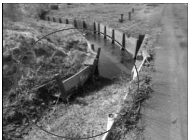
④ 排水路が破損している。
