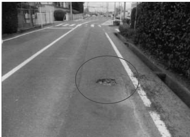
① 舗装に穴があいている。
